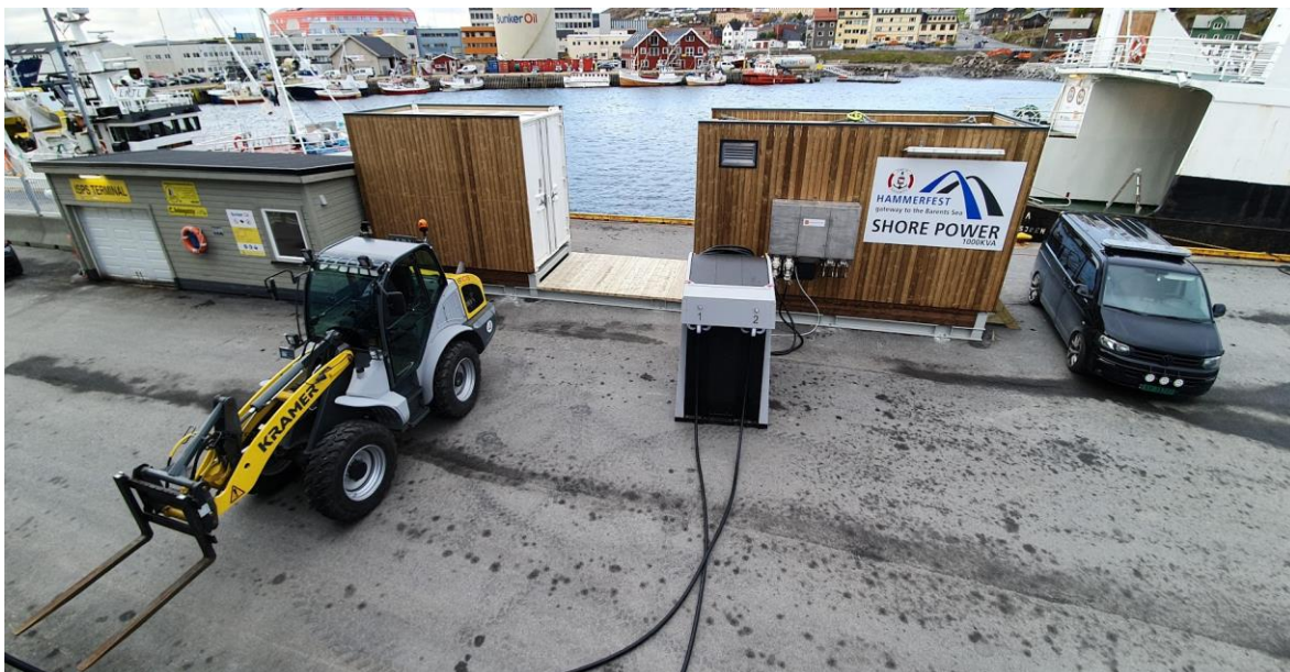
Miljøsatsing, åpning av landstrømsanlegg. Foto: Hammerfest Havn KF
